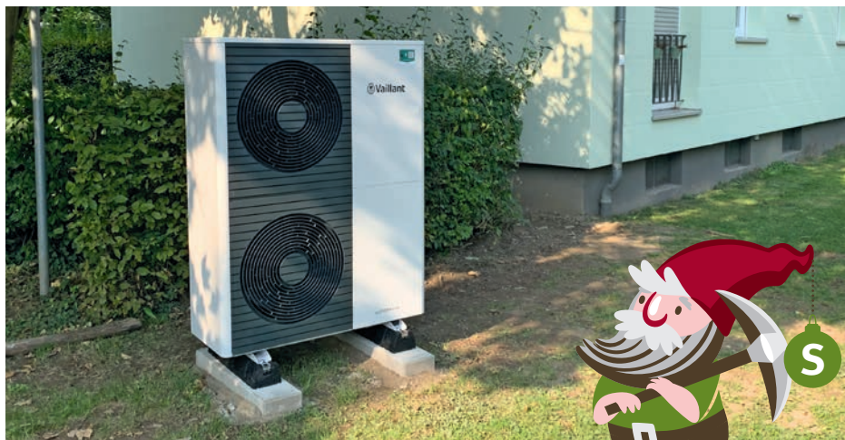
Wärmepumpe in der Anne-Frank-Straße 22 a
